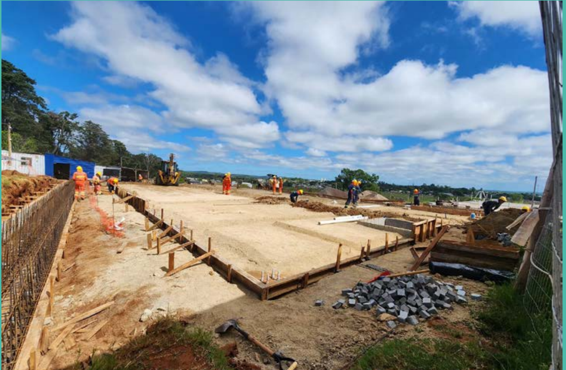
Foto: Gimnasio en construcción, Centro Universitario Rivera (CUR), 2024 - Unidad de Comunicación del ISEF
